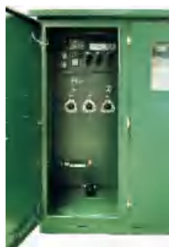
高压室 High pressure chamber
