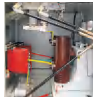
断路器室 Circuit breaker room
