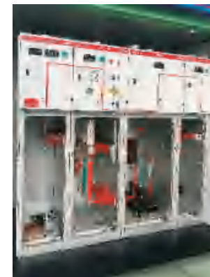
高压室 High pressure chamber
