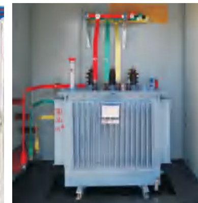
变压器室 Transformer room
