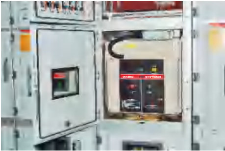
主断路器室 Main circuit breaker room
