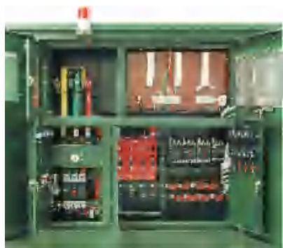
低压室 Low pressure room
